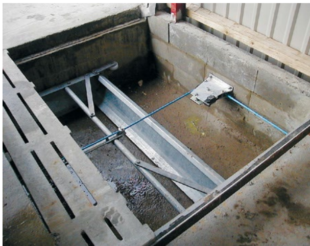
Figur 8.19. Linespilsanlæg monteret i gødningskanalen under spaltegulvet (Foto: SEGES).
